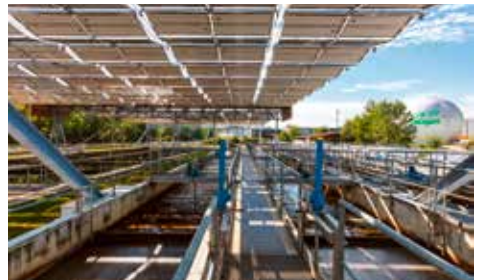
Kläranlage: Belüftungsbecken mit neuem Solarfaltdach
