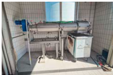
Neue Schlamm-siebung auf der ARA
